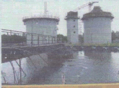
W części Klimzowca, gdzie odbywa się proces biologicznego oczyszczania ścieków, najbardziej zaawansowane są prace związane z budową wydzielonych komór fermentacji.
